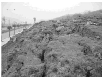
图 2 膨胀土滑坡照片
